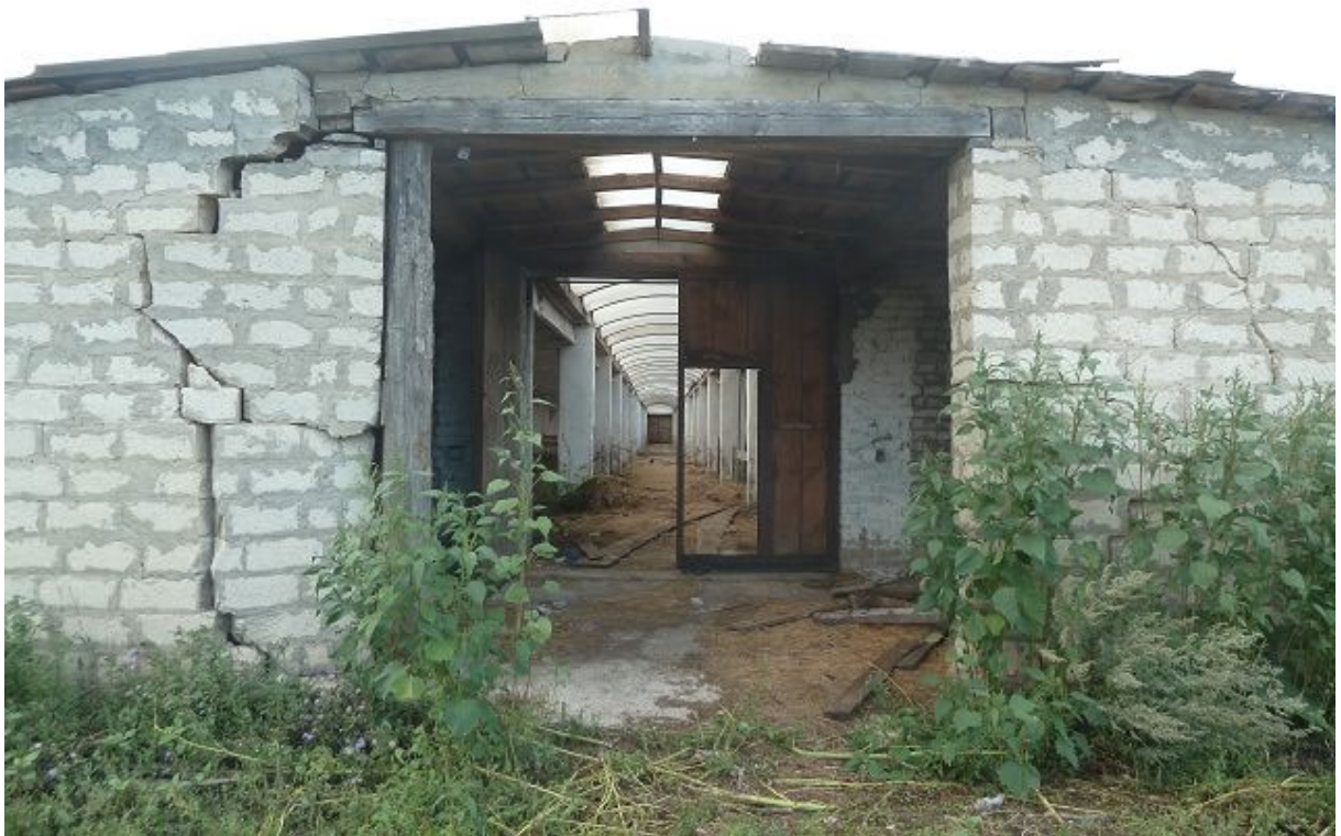
Bild 7: Verfallenes Gebäude – Station Staryy Buyan
