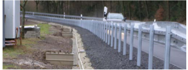
▲ Leiteinrichtung aus Beton mit integrierter Lauffläche
