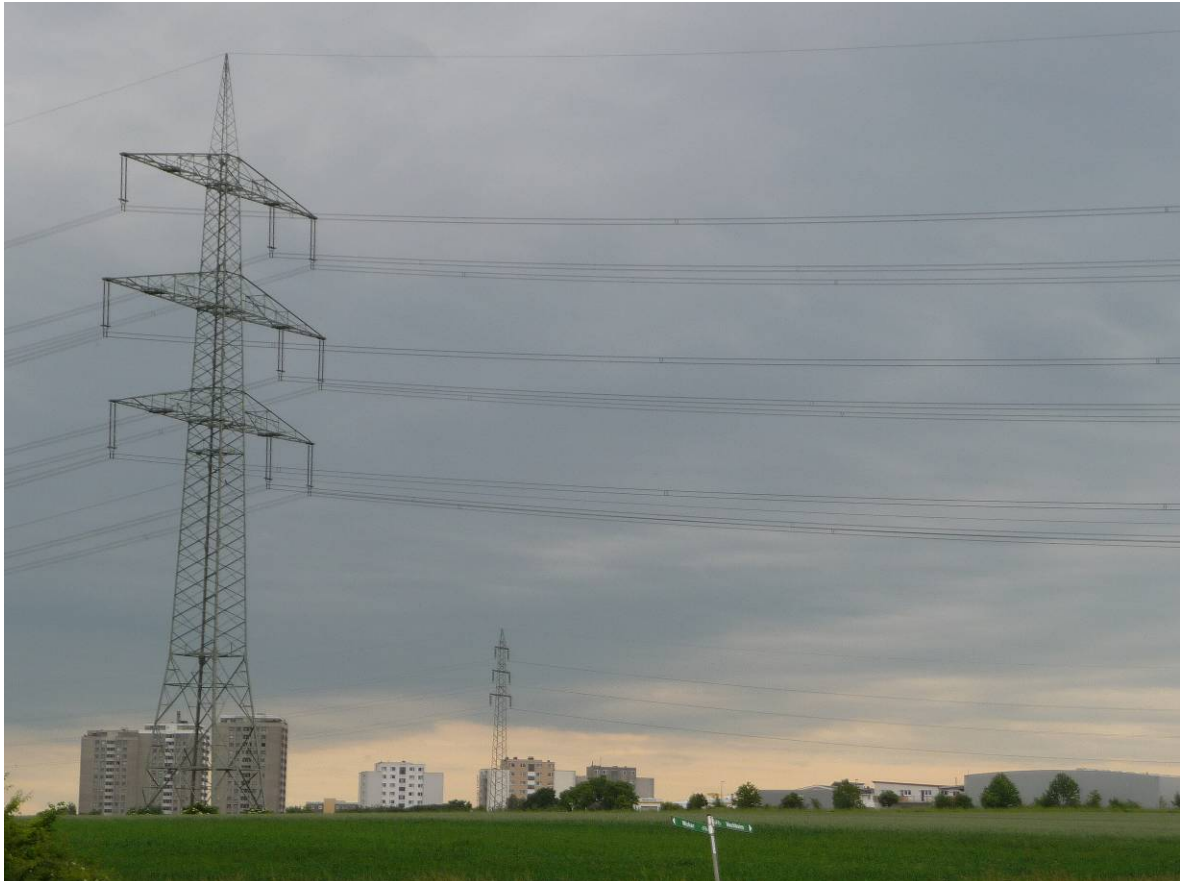
Abb. 14: Freileitungsmasten im Bereich von potenziellen Siedlungserweiterungsflächen (Foto: Herrchen & Schmitt)
